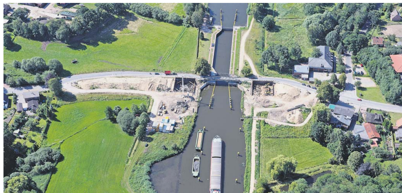
Im Bau: Die Gruben rechts und links des Elbe-Lübeck-Kanals für die Fundamente der neuen Brücke sind ausgehoben. Die daneben zu erkennende alte Brücke von 1900 wird nach deren Fertigstellung abgerissen.
